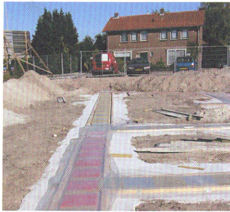
De trillingisolerende matten op de sloof (rood). Tussen de matten het steenwol.
